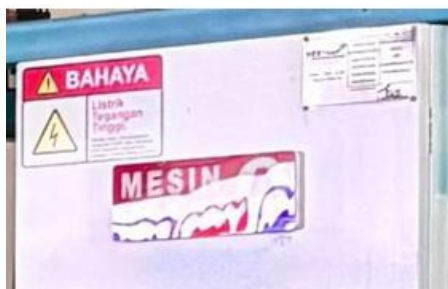
Gambar 8. Bahaya Listrik Tegangan Tinggi
